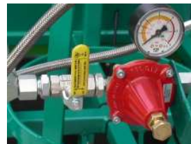
Vanne d'arrêt, détendeur et manomètre
